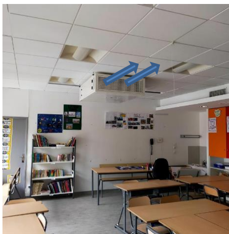
Figure 26 : Epurateur NPS Optimal fixé au plafond de la salle de classe N°6 (Flèches bleues : sens d'évacuation de l'air filtré)
