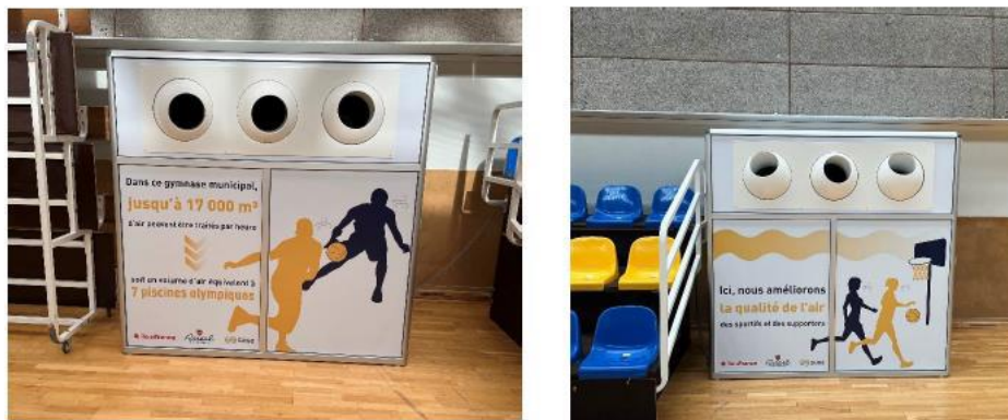
Figure 33 : Modules de traitement CC600 pilotables à distance
