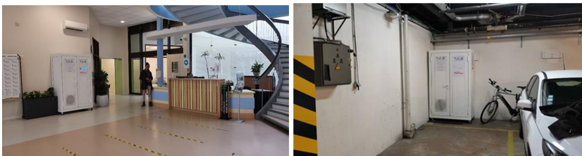
Figure 14 : Implantation des systèmes de dépollution dans le bâtiment de la mairie de Garges-lès-Gonesse (à gauche) et dans le parking souterrain (à droite)
