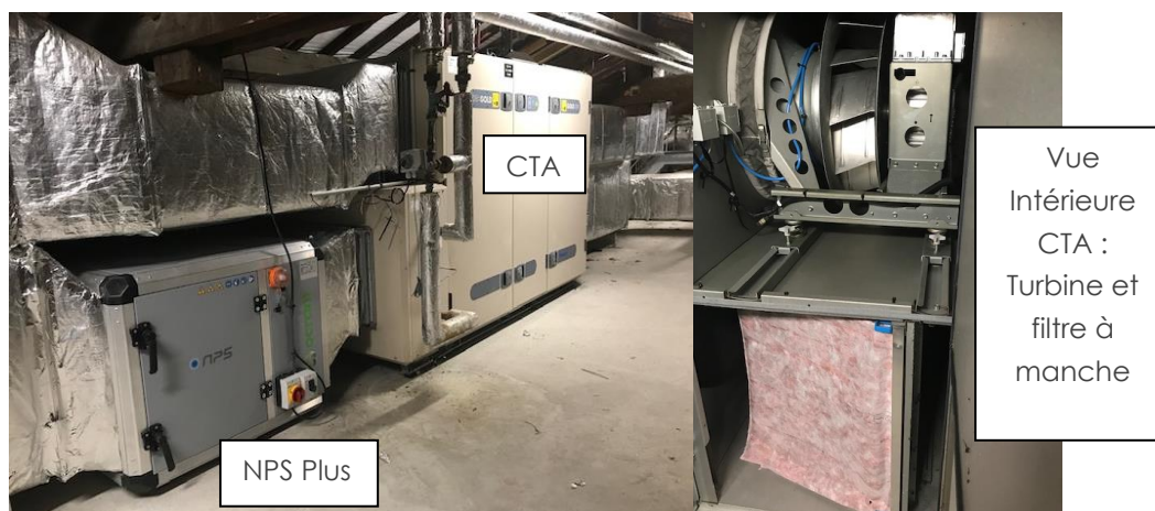
Figure 27 : A gauche - Epurateur NPS Plus couplé à la CTA de la salle N°11 ; A droite vue intérieure CTA
