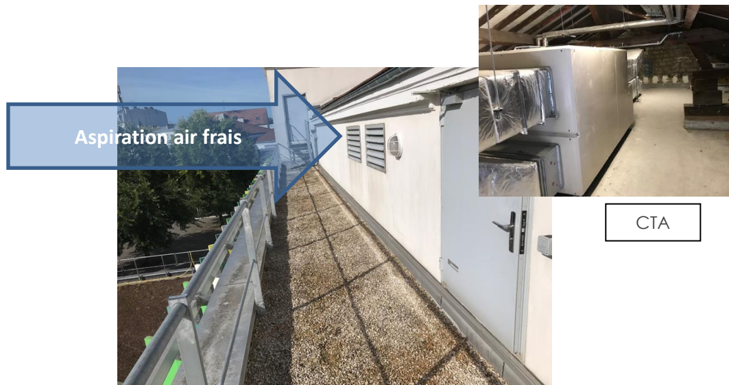
Figure 25 : Bouches d'aspirations d'air frais et CTA implantées sous le toit
